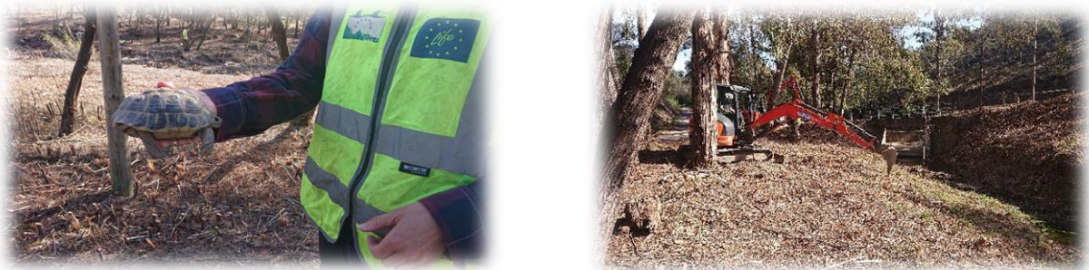
Figure 6 : Photographie prise sur le chantier de l'ouvrage DFCI H90 La Louve – commune de Fréjus
